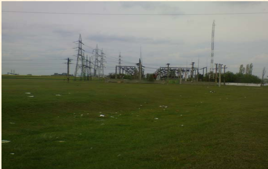
Statia de transformare
